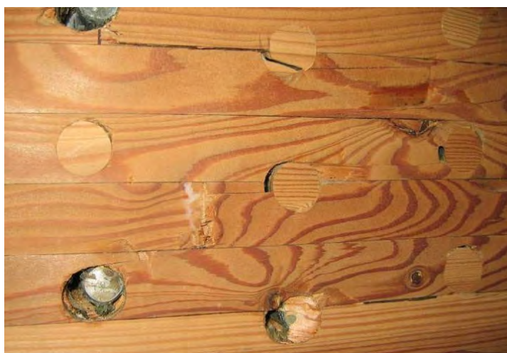
Abb. 4.2: Schub- und Zugbrüche in einer Zugverbindung aufgrund Blockscherversagens
