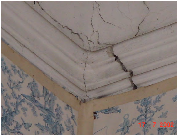
Abb. 2.4: Risse im Mauerwerk direkt unter Dachboden, Rissweite > 1 cm
