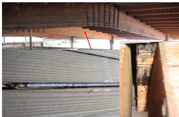
Abb. 4.4: Satteldachträger mit Riss von Auflager zu Auflager
