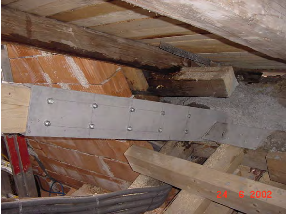
Abb. 4.8: Fußpunkt Vollgespärre mit Verstärkung, nur der Stahl reicht in das neue Betonaufleger
