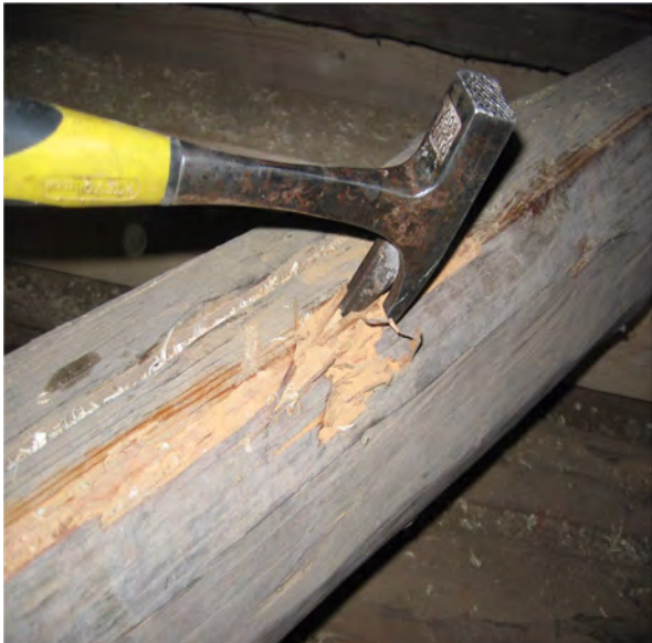
Abb. 2.1: Zustandsfeststellung mittels Hammerprobe – geschädigtes Holz
