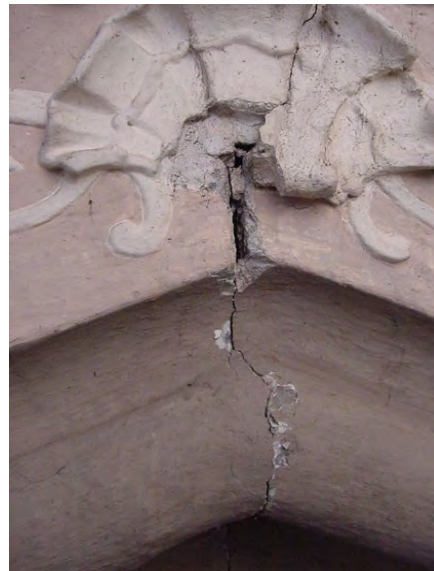
Abb. 2.5: Riss im Gewölbescheitel Stift Zwettl (13 Jhdt)
