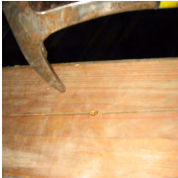
Abb. 2.2: Zustandsfeststellung mittels Hammerprobe – gesundes Holz
